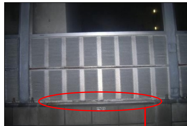
遮音壁(損傷全景)
