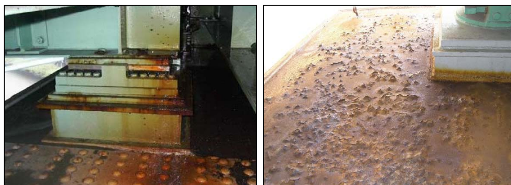
支承の錆や梁天端の錆
