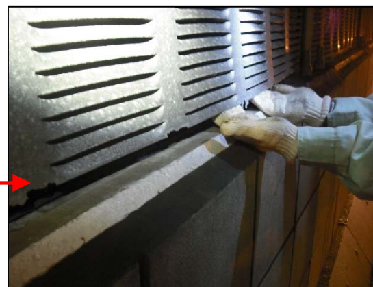
遮音壁(損傷近景)
