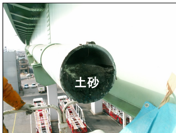
排水管(土砂堆積)
