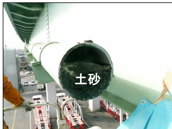
排水管(土砂堆積)
