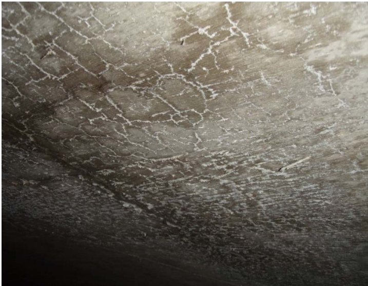
二方向ひび割れ
