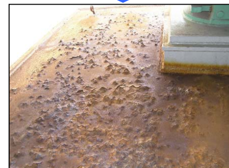
橋脚梁天端の錆
