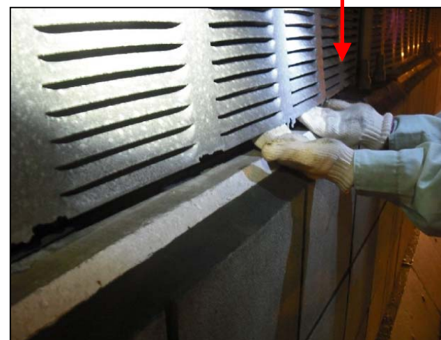
遮音壁(損傷近景)
