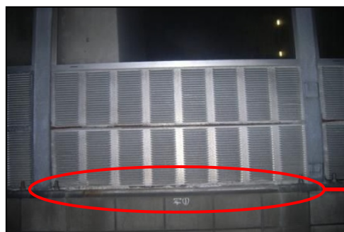
遮音壁(損傷全景)
