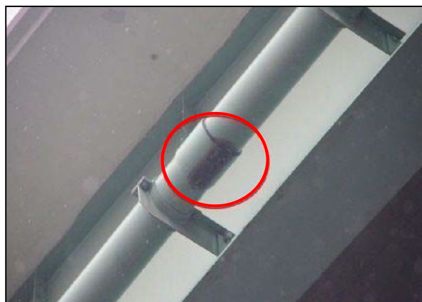
排水管継手部からの漏水
