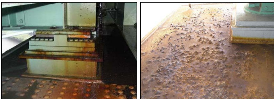
支承の錆や梁天端の錆
