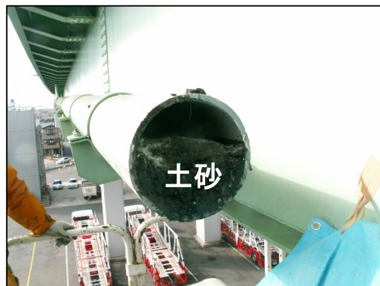
排水管(土砂堆積)
