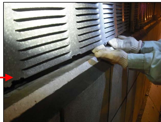
遮音壁(損傷近景)
