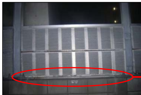
遮音壁(損傷全景)
