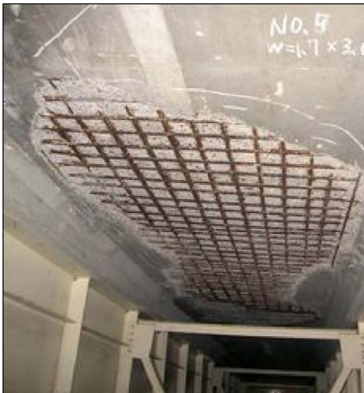
床版下面の損傷
