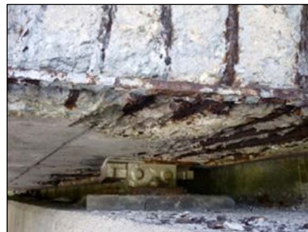
橋梁桁端部の損傷
