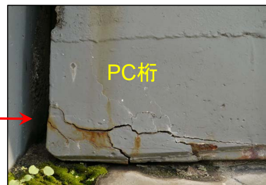
PC桁の損傷(外桁部)
