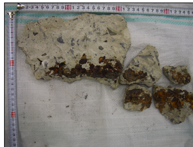
落下したコンクリート片
