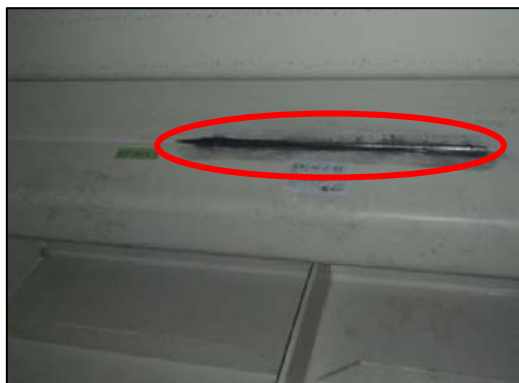
デッキとUリブの溶接部のき裂
