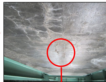
格子状の ひび割れ
