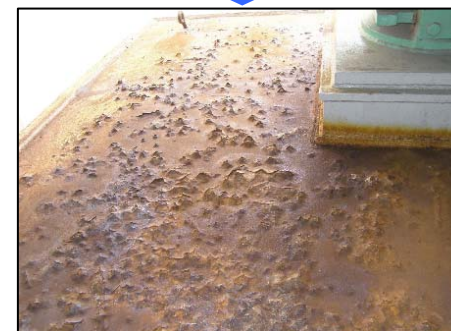
橋脚梁天端の錆
