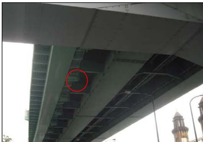
コンクリート片の落下した箇所
