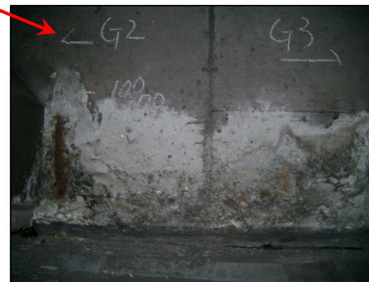
PC桁の損傷(横桁部)
