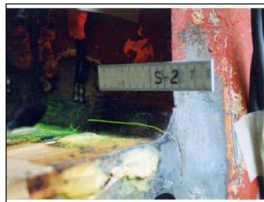
橋脚隅角部クラック
