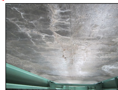
コンクリート床版の損傷(ひび割れ)
