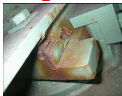
鋼製支承の損傷(漏水による錆)
