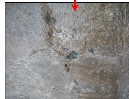
ひび割れ部 からの漏水
