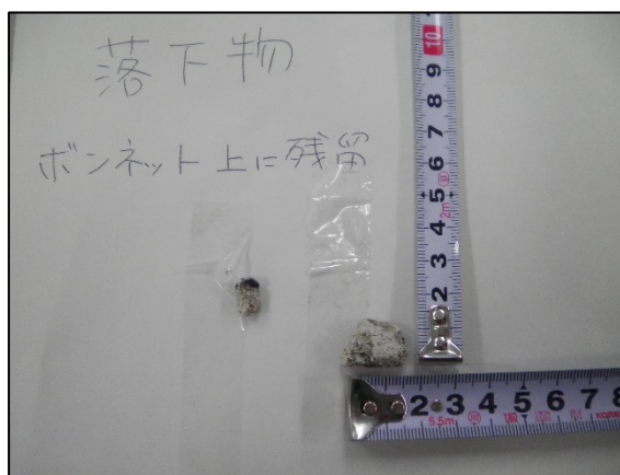
落下したコンクリート片
