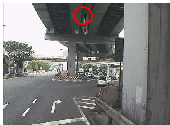
コンクリート片の落下した箇所
