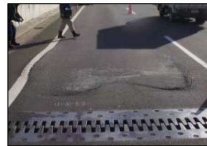
舗装の損傷(流動)
