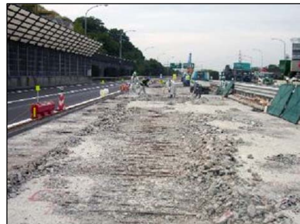
床版上面の損傷
