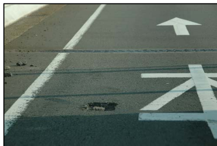
舗装の損傷(ポットホール)
