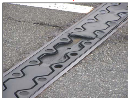
伸縮装置の損傷
