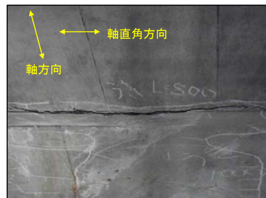
打ち継部のひび割れ
