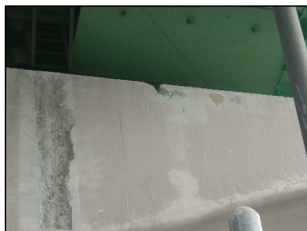
コンクリート梁の損傷(欠け落ち)
