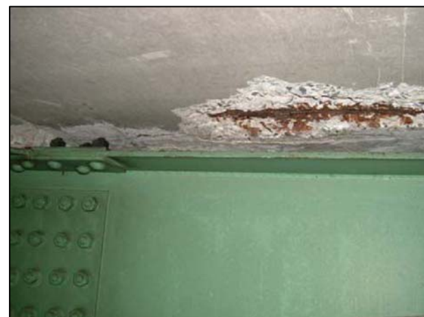
コンクリート片の落下した箇所
