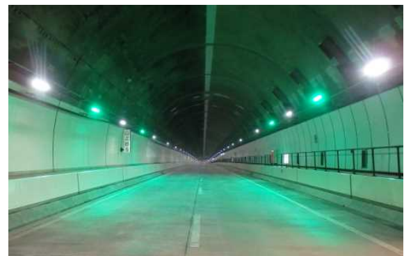
L E D化が完了した東山トンネルの様子
