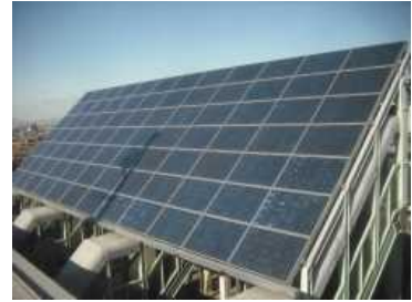
<料金所に設置した太陽光発電>
