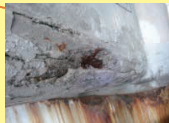
橋脚(梁)の損傷
