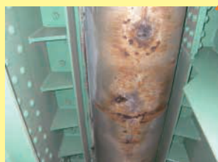
伸縮装置の損傷(樋の破損)
