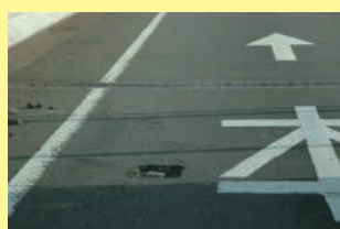
舗装の損傷 (ポットホール)
