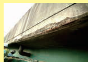
コンクリート高欄の損傷 (欠け落ち)
