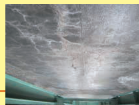
コンクリート床版の損傷 (下面のひび割れ)
