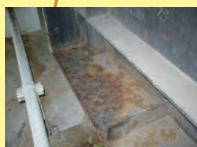
鋼桁の損傷(漏水による錆)
