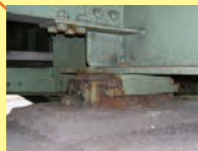
鋼製支承の損傷 (漏水による錆)
