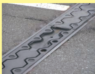
伸縮装置の損傷
