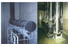
路面排水ポンプ
