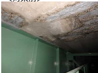
床版下面の損傷状況
