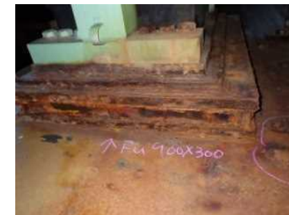
支承部の損傷状況
