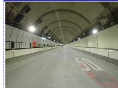
LED照明 (東山トンネル)
