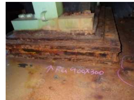
支承部の損傷状況
