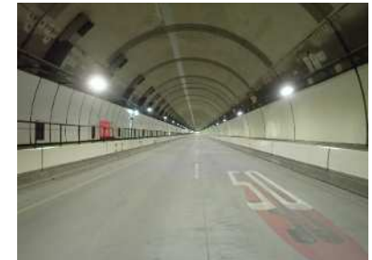
LED照明 (東山トンネル)
