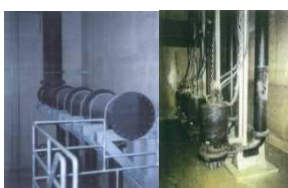
路面排水ポンプ
