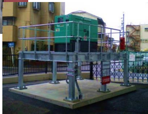
事務所非常用発電機の設置例
