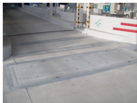
軸重計測装置
