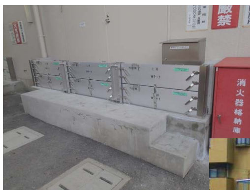
受変電施設の止水板設置例
