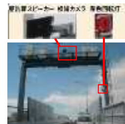
逆走検知・警告システム (吹上東出口)
