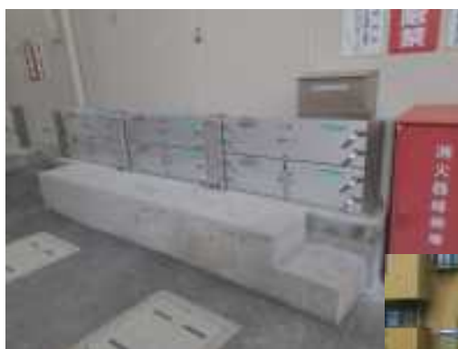
受変電施設の止水板設置例
