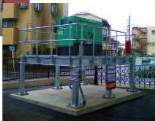
事務所非常用発電機の設置例
