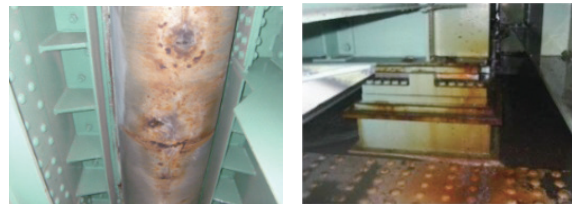
写真-2 伸縮装置損傷状況 写真-3 支承腐食状況
