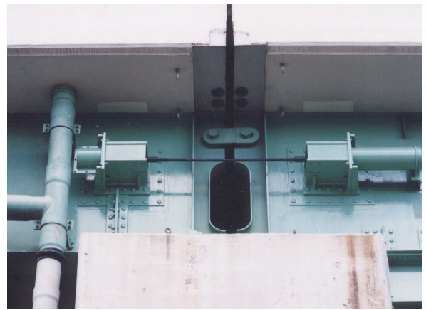
写真9-1-5 落橋防止装置(PCケーブル)
