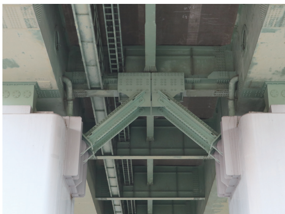
写真9-1-6 座屈拘束ブレース
