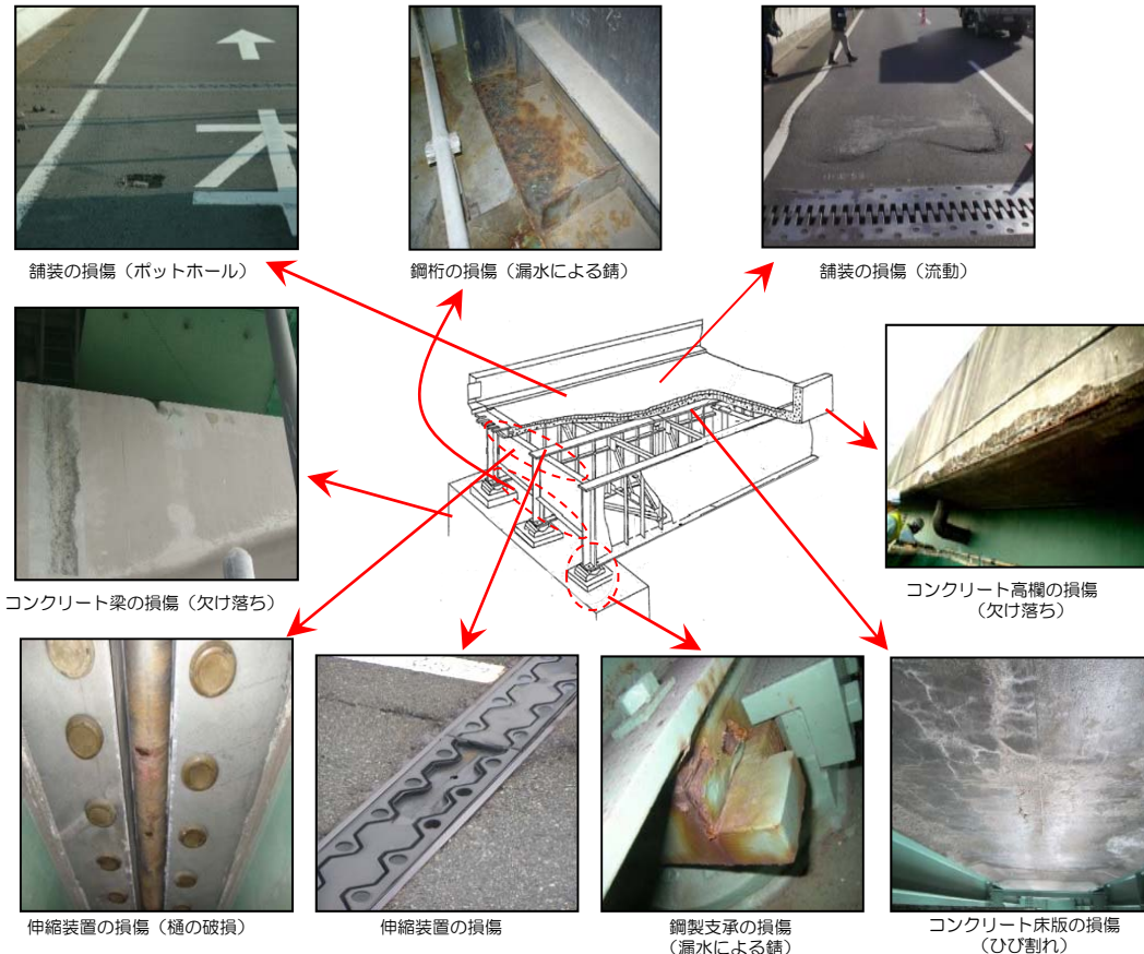
構造物の損傷発生状況
