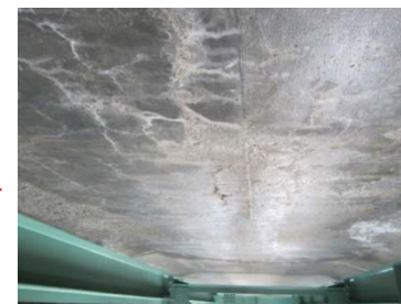
格子状（2方向）のひび割れ （ひび割れからの漏水跡）
