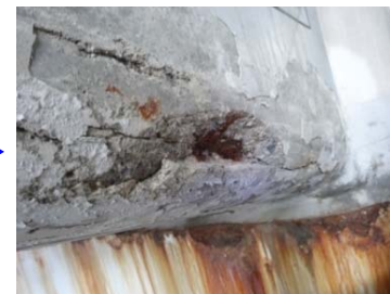
橋脚梁部の 浮き・はく離・ひび割れ・錆汁
