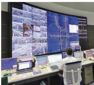
交通管制室ではモニターを見ながら組織で連携し、24時間365日体制で交通安全をサポート
